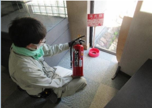
消火器点検中
