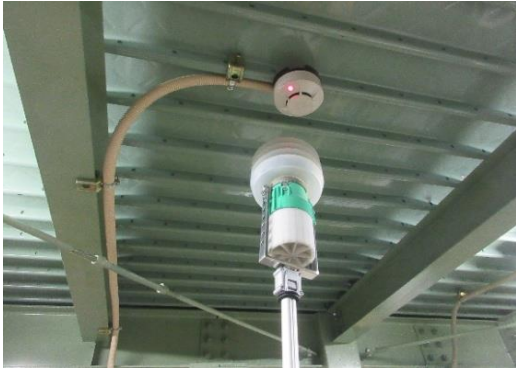
煙感知器作動試験中
