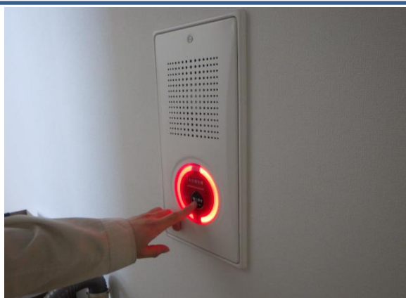
消防設備点検
