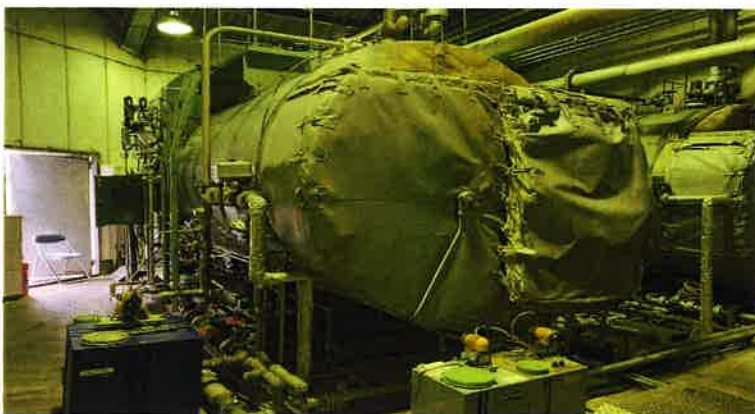
機械ホール室
