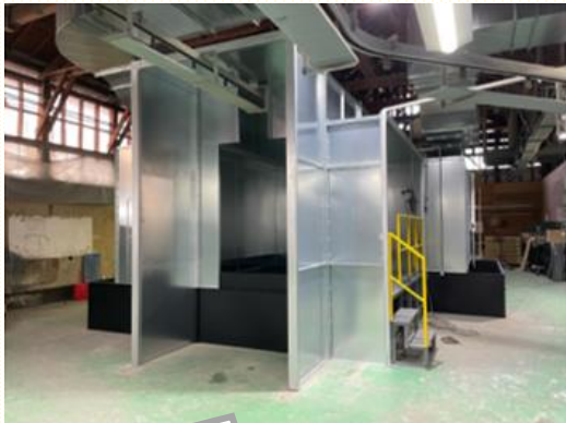
コンベア型ライン塗装ブース
