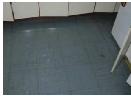
【床】 石綿含有ビニル床タイル
