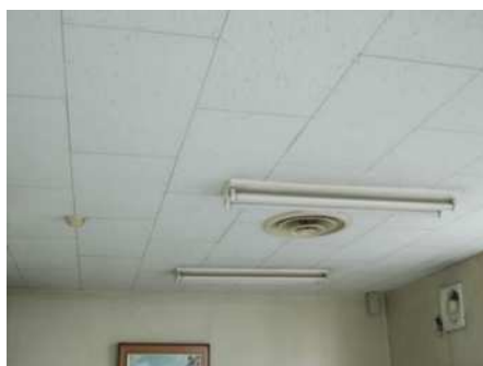
【天井】 石綿含有ロックウール吸音天井板
