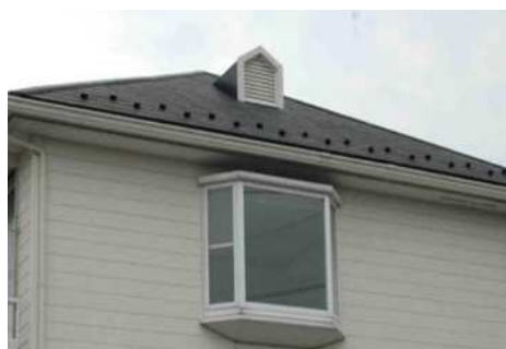
【外壁】 石綿含有窯業系サイディング
