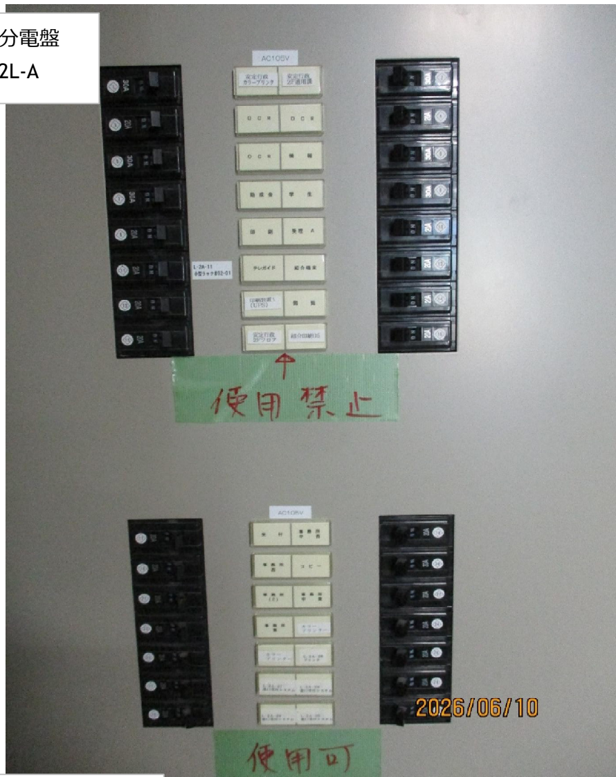
分電盤2L-A下拡大
