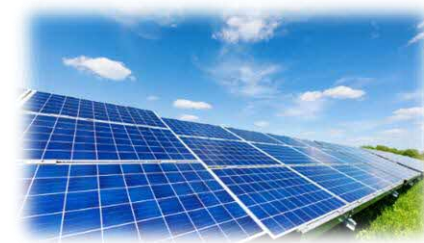
太陽光発電システム
