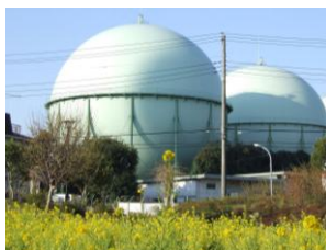
プラント設備
