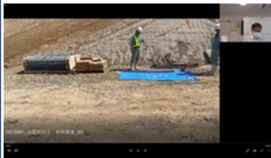
【立会状況（接続画面）】
