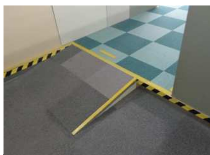
事務室内の段差を明示
