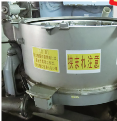
機械設備に貼られた注意事項
