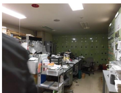
電気機械設備管理室
