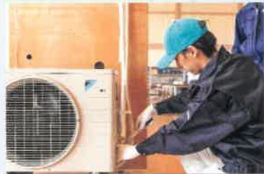
エアコン(空調設備)
