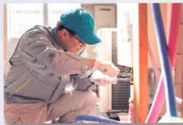
水道(給排水設備)
