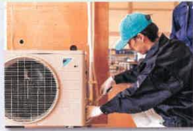
エアコン(空調設備)
