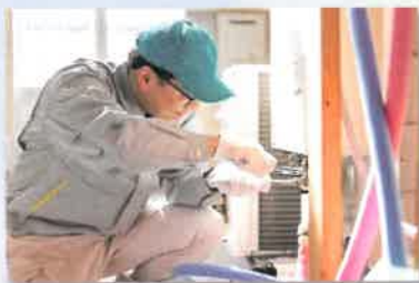
水道(給排水設備)
