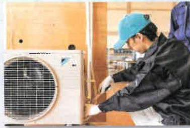
エアコン(空調設備)
