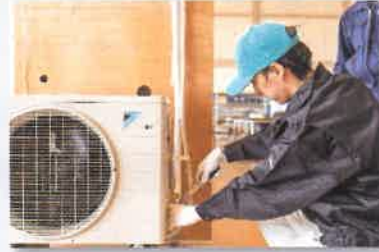
エアコン(空調設備)
