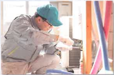
水道(給排水設備)
