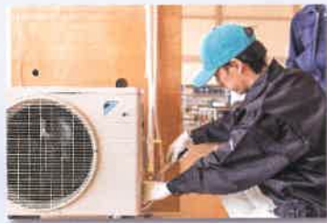
エアコン (空調設備)
