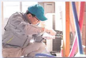
水道 (給排水設備)
