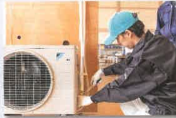
エアコン (空調設備)
