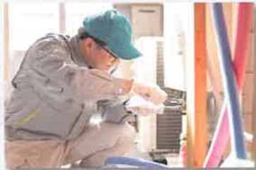
水道 (給排水設備)
