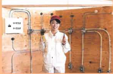
住宅電気配線
