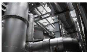
プラント配管
