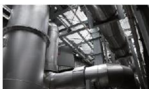
プラント配管
