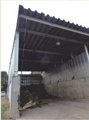
写真① 墜落制止用器具取付設備
