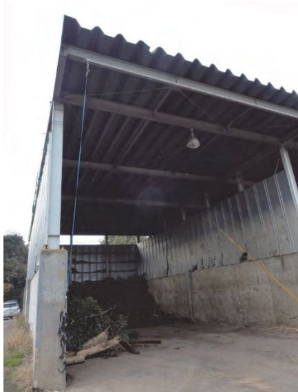
（写真1）墜落制止用器具取付設備
