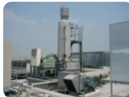
排ガス処理設備
