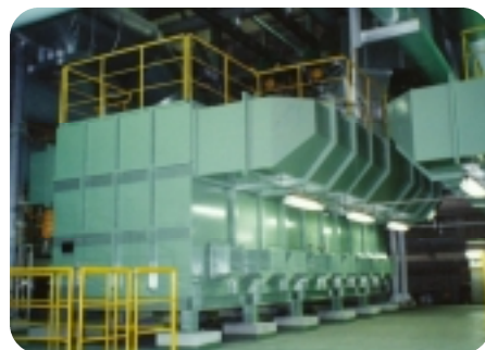
活性炭脱臭設備
