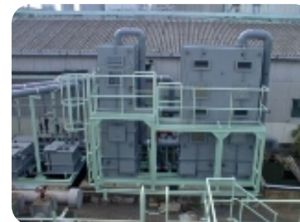
生物脱臭設備
