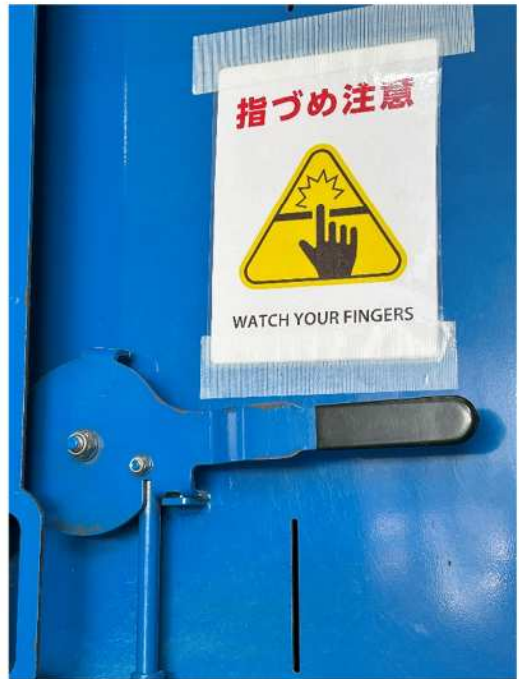
圧縮機の扉に指づめ注意の注意喚起をしました
