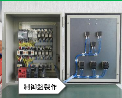
シーケンス制御(PLC)
