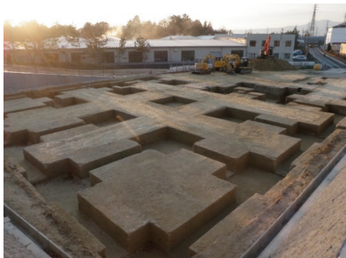
株式会社タケウチ建設が保有する TNF工法の完成風景
