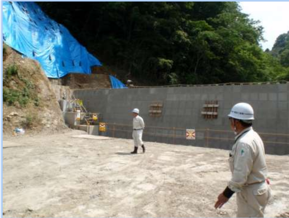
(現場を案内していただきました元請の方々。ご協力ありがとうございました。 写真中央は、堰堤を下流側から見た状態。)
