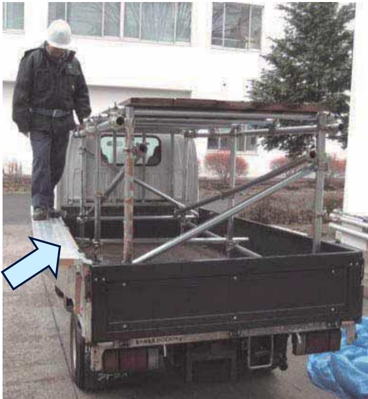
あおりに取り付けられた 簡易作業床
