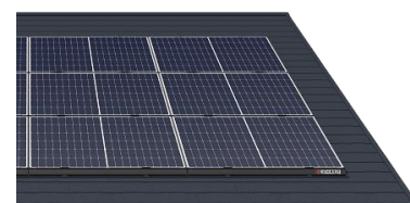
【太陽光発電システム】
