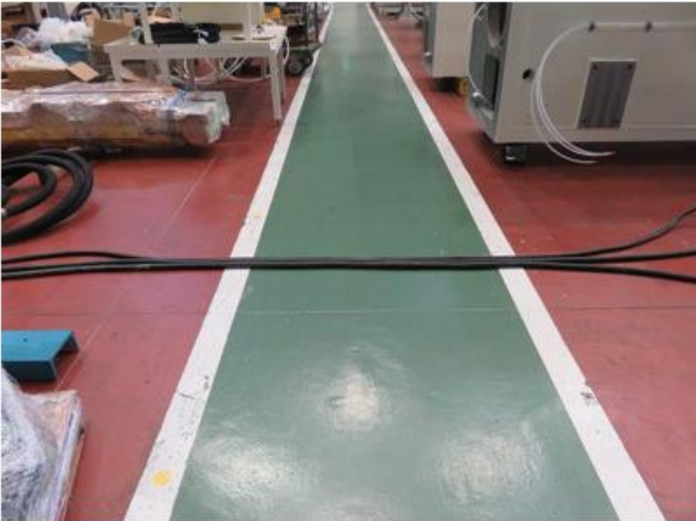
ア. フロアに這っている電線ケーブル（改善前）
