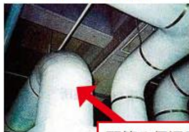
配管の保温用
