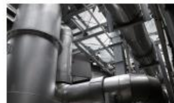
プラント配管
