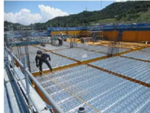
・手すり設置困難箇所へは親綱が設置
