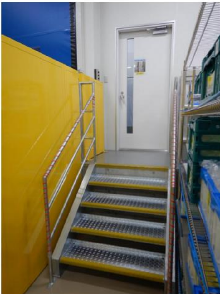
(左) 階段の踏みはずし対策
