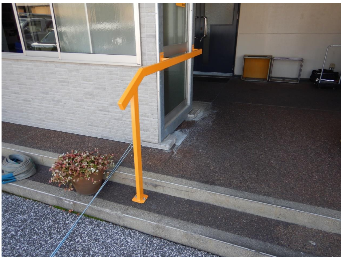
2段のステップに手すりを設け、視認しやすいように黄色塗装。
