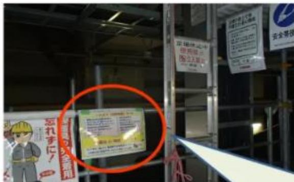
現場の作業場所に掲示
