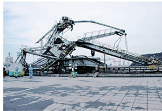
クレーンの崩落災害
