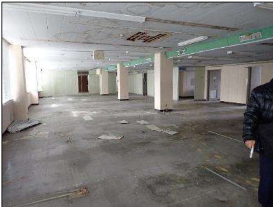
図-3-38：事務室の床の状態-1
