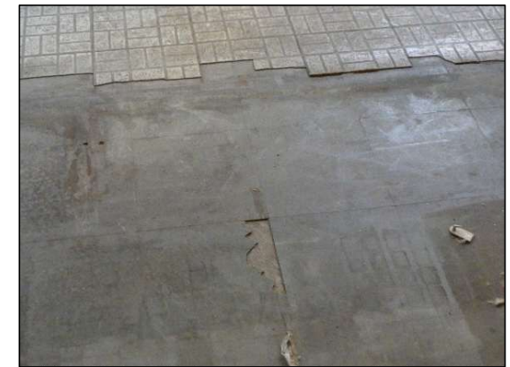
図-3-40：事務室の床の状態-3 ビニル床タイルが2層になっている
