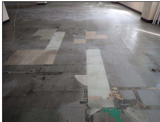
図-3-39：事務室の床の状態-2
