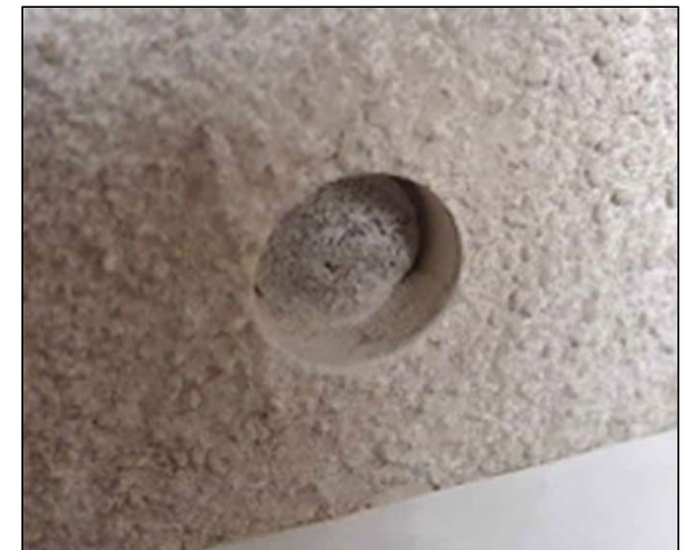
図-8-5：コアサンプル採取跡 (表面から躯体コンクリート面まで 円柱形で採取⇒層別分析可能)
