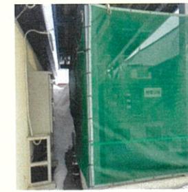
導入した非常用自家発電機
