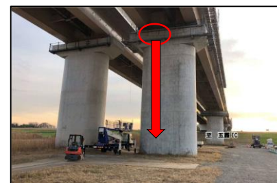
橋梁の下部工検査路設置作業中、作業員1名が転落し死亡が確認された事案
