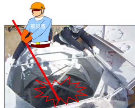
土質改良機の清掃作業中に作業員の死亡が確認された事案
