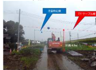
バックホウのアームを上げたまま走行したことにより架空線を損傷した事故の写真
