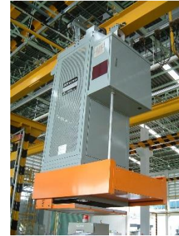
自動配湯装置
