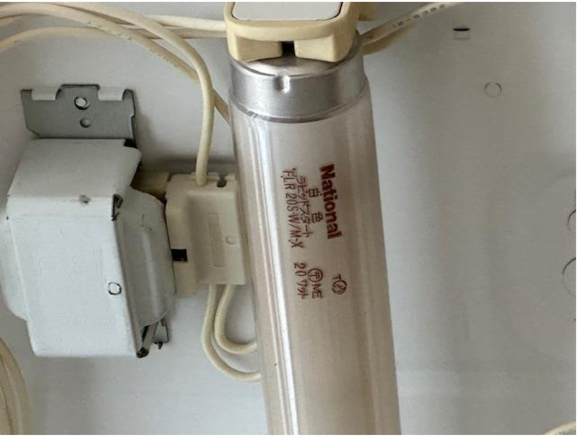
⑥2階休憩室 蛍光灯
