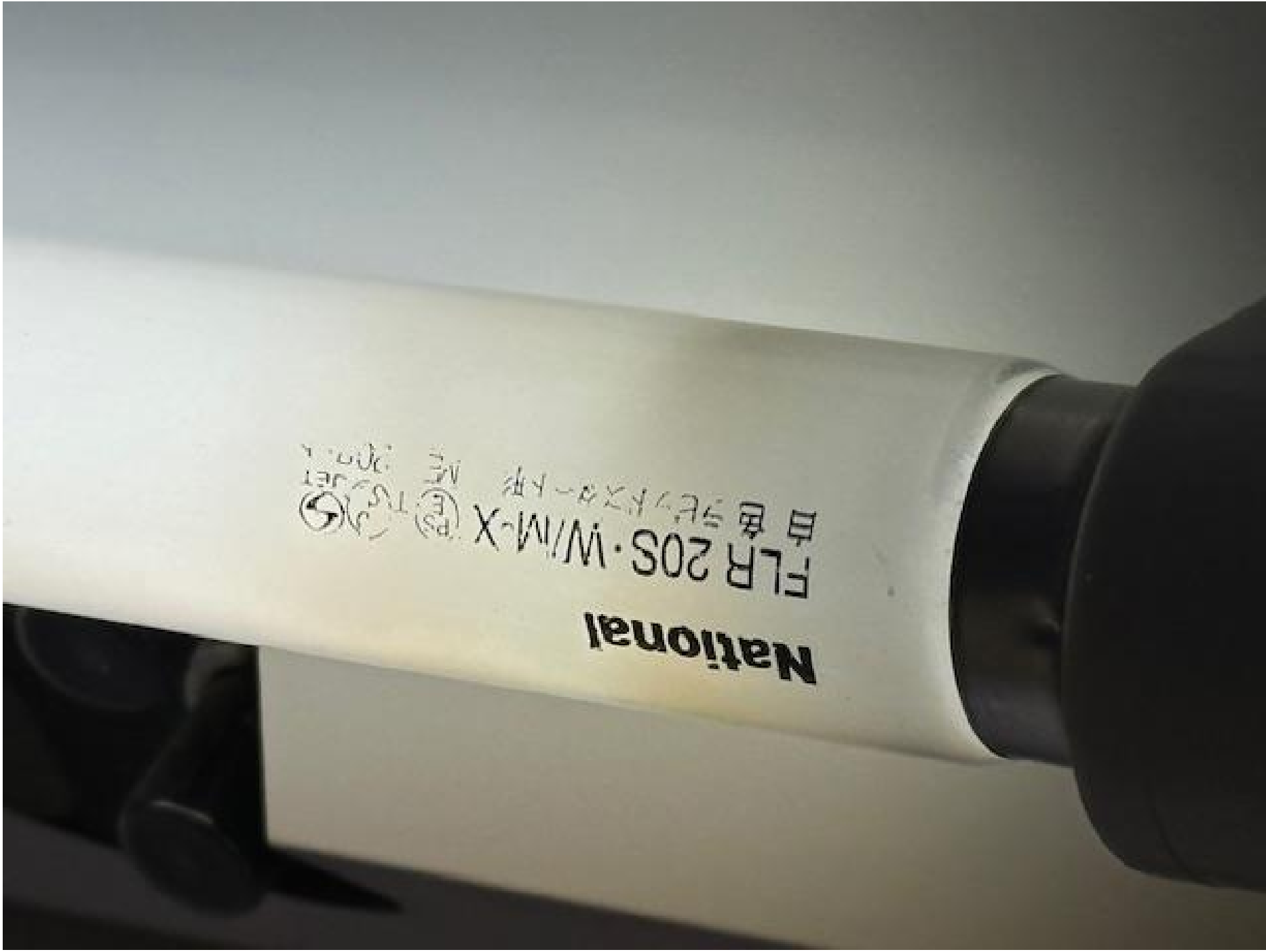
⑦階段踊り場&1階トイレ前 蛍光灯
