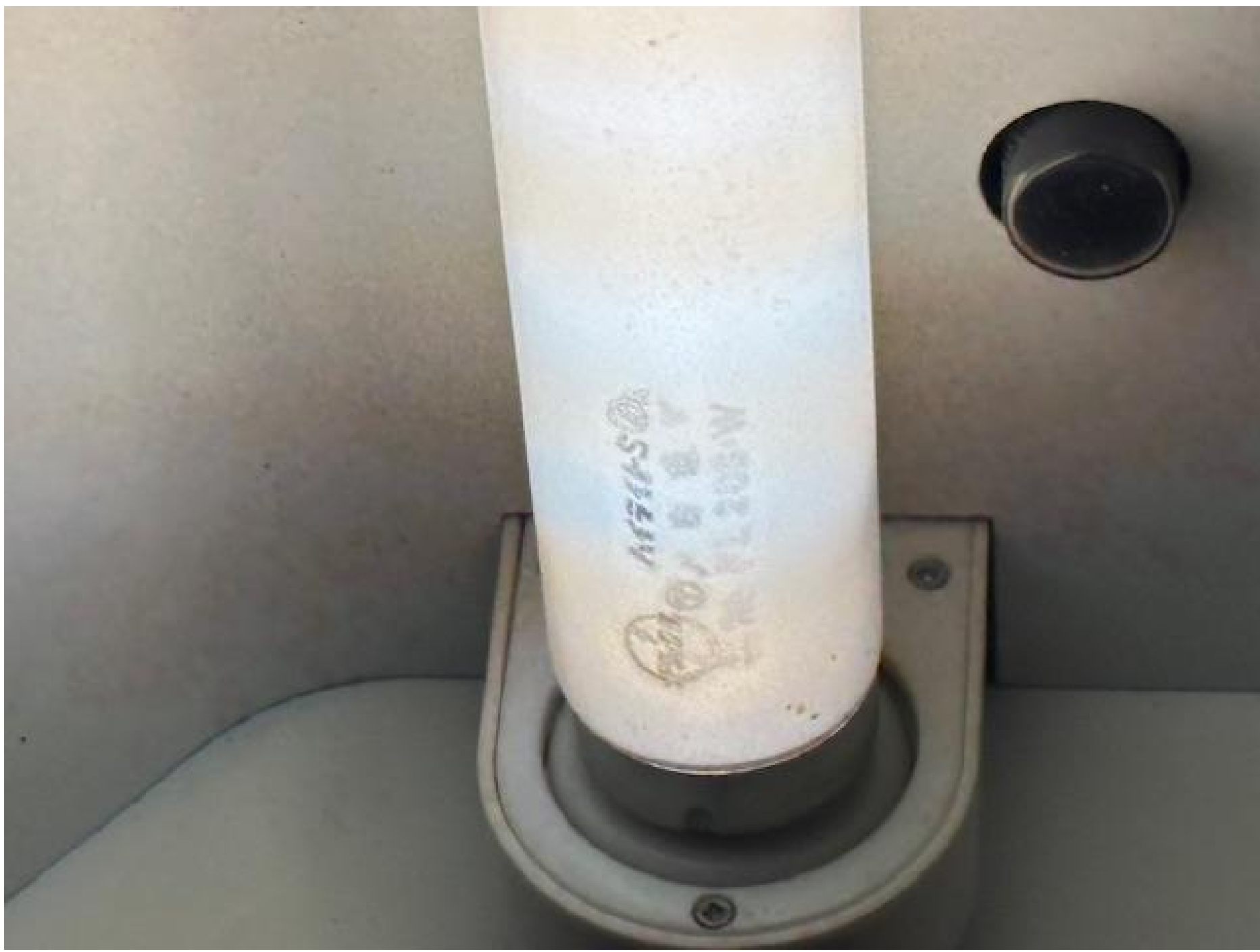
③トイレ蛍光灯
