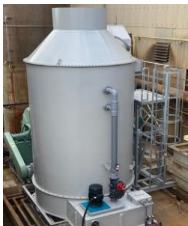
排ガス処理装置
