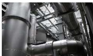
プラント配管
