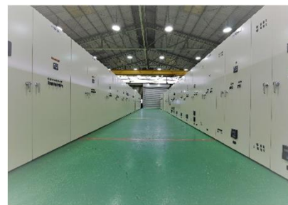
完成したキュービクル
