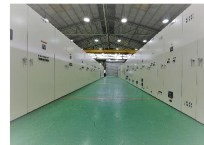
完成したキュービクル
