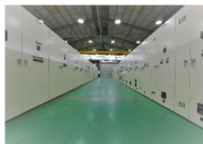
完成したキュービクル
