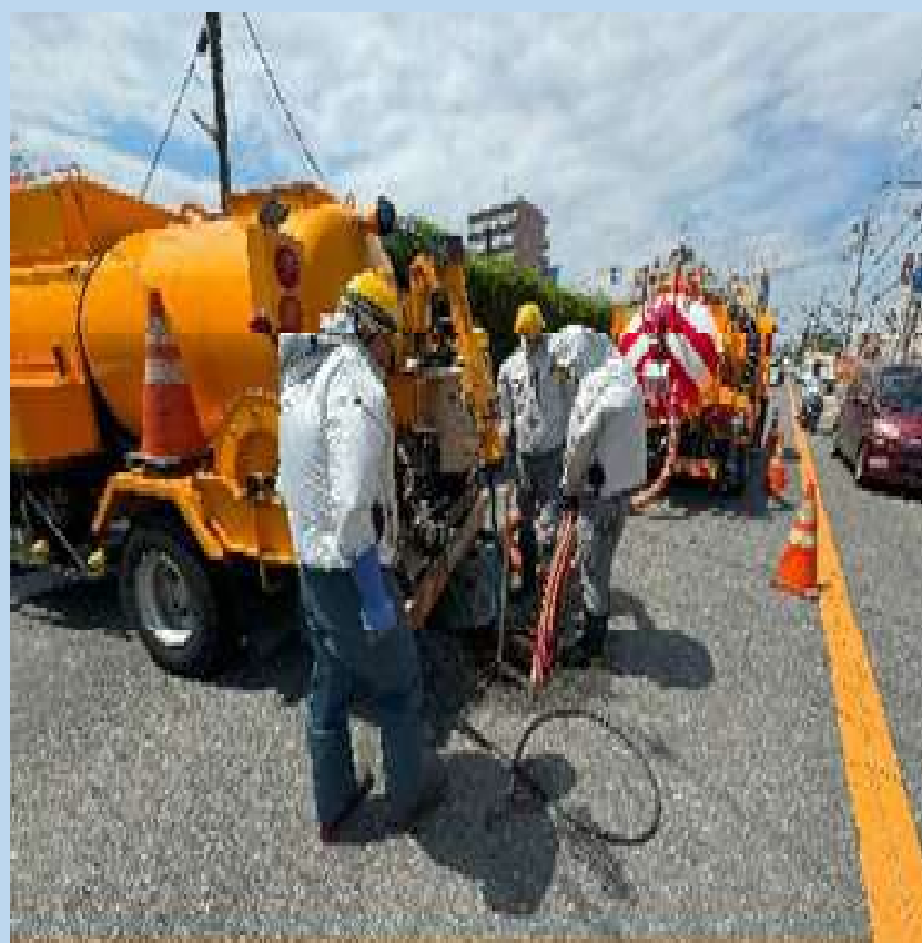
高圧洗浄車(奥)と強力吸引車(手前)
