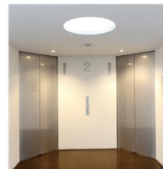
エレベーター
