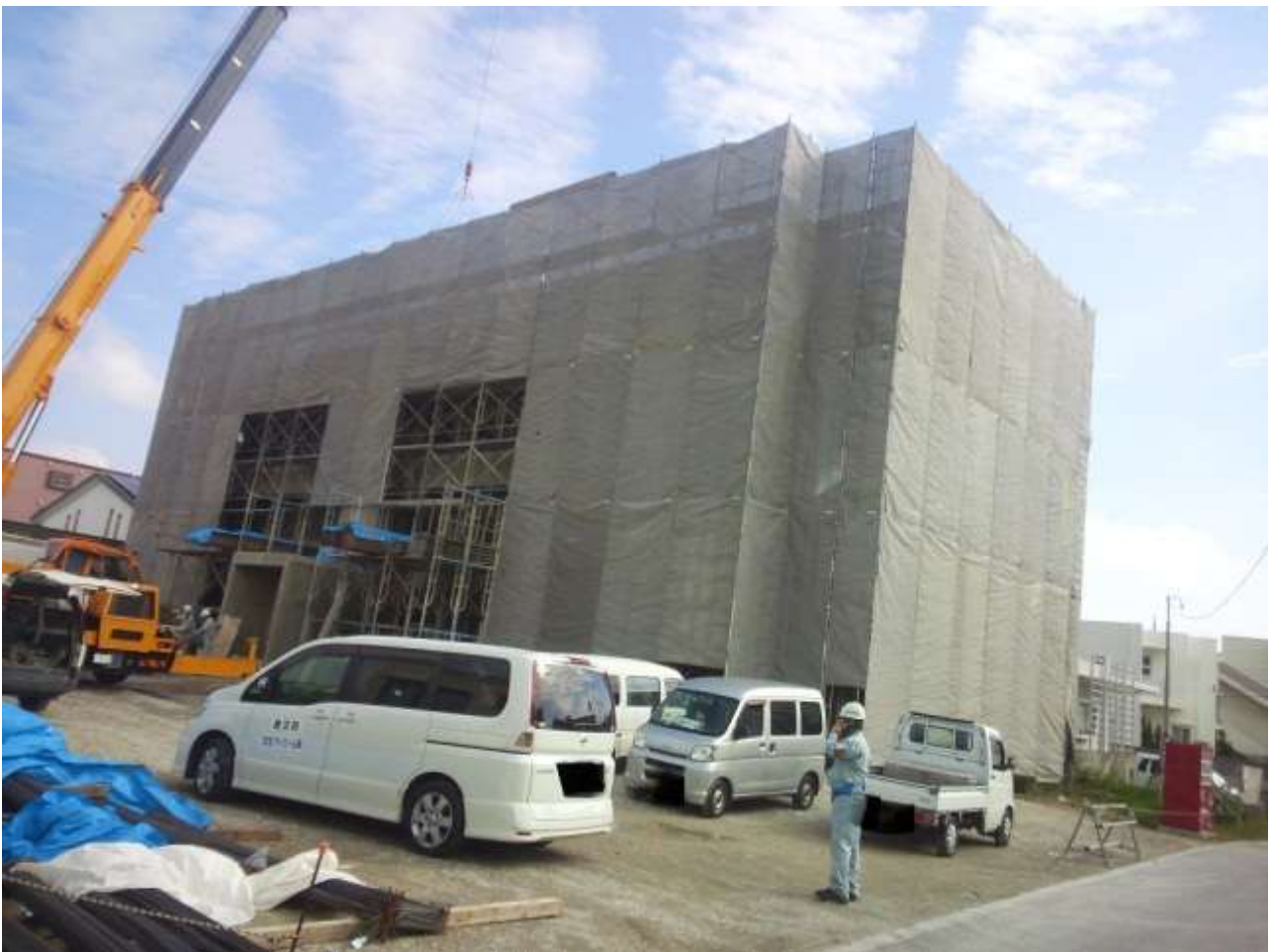
屋上への資材荷揚げが行われていた現場。元請の監督員は誰もいませんでした。
